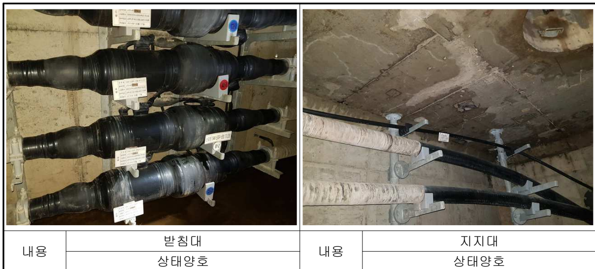
【사진 13.36】 부속 및 부대설비 현황
