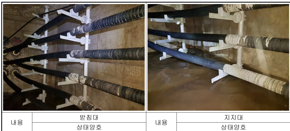
【사진 13.24】 부속 및 부대설비 현황
