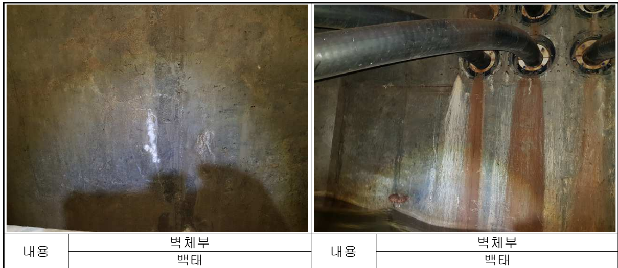
【사진 13.18】 맨홀 내부 주요 손상
