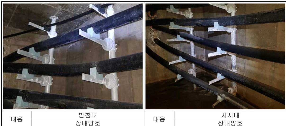
【사진 13.16】 부속 및 부대설비 현황
